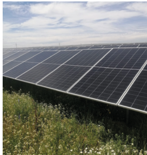
Planta Fotovoltaica “Toscano Solar” Cubillos (Zamora)
