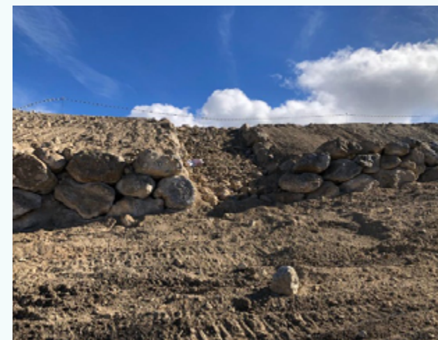
Disipador de energía
