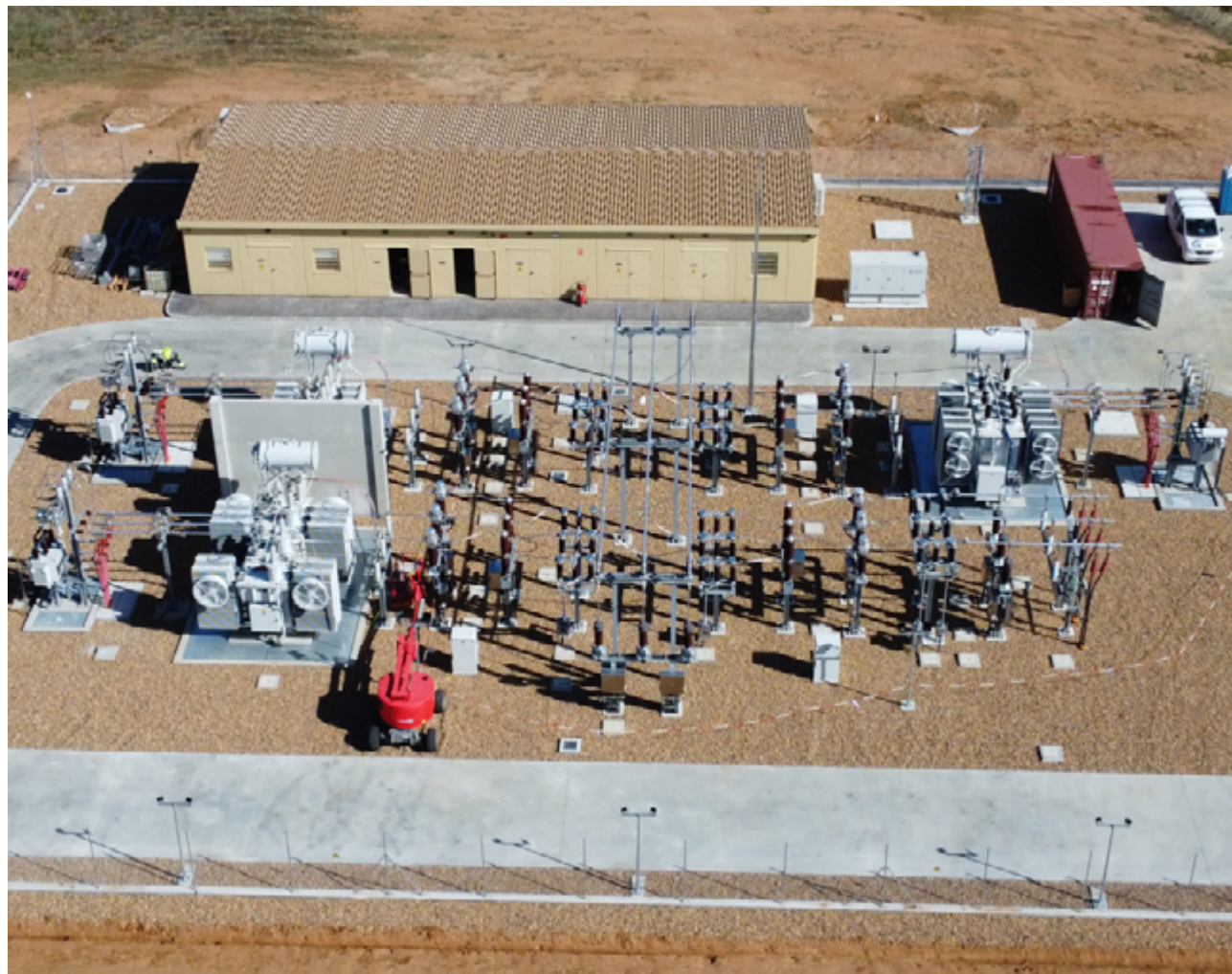
Subestación digital Majuelo 66/30 kV
