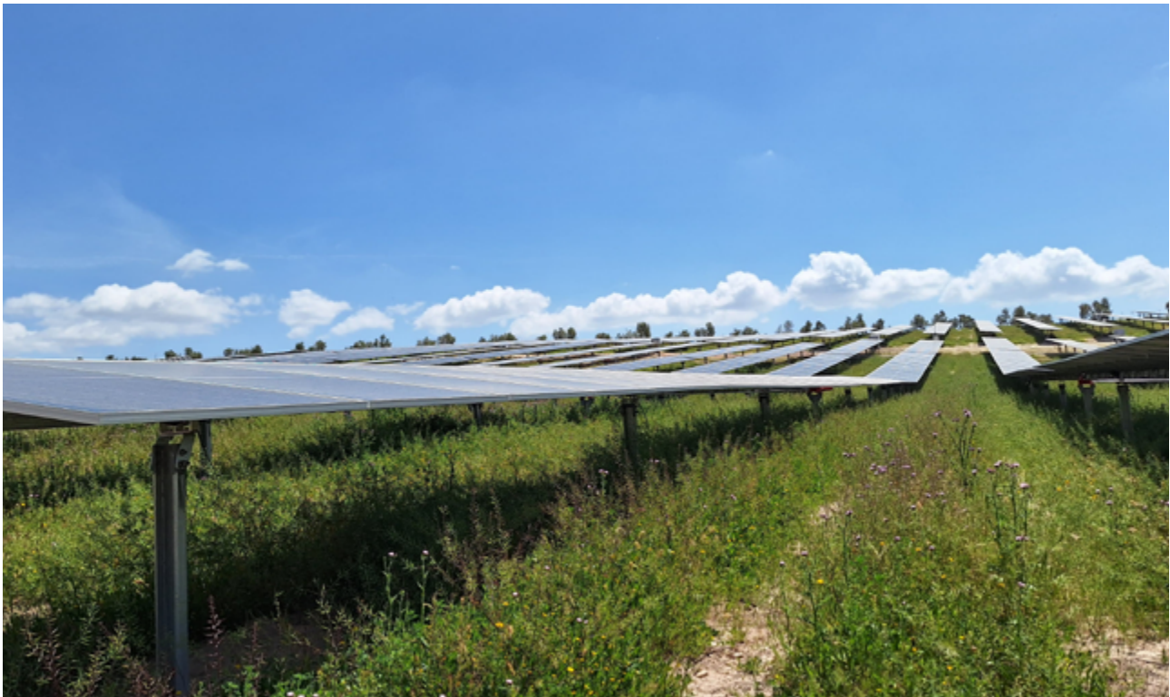
Planta Fotovoltaica “PFV Guadacano” Antequera y Archidona (Málaga)
